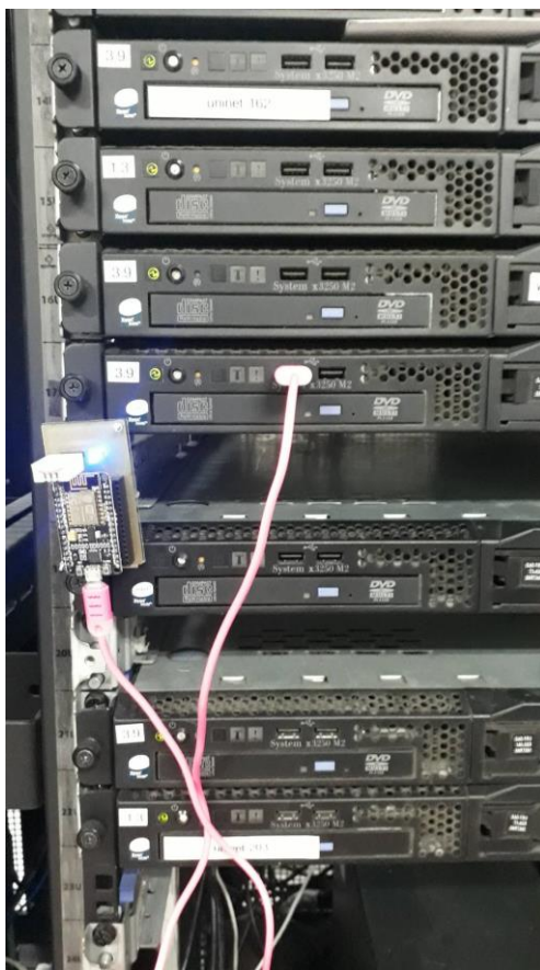
ภาพที่ 4.2 การติดตั้ง ESP8266 และเซนเซอร์วัดอุณหภูมิ DHT22 ผ่านเครื่องควบคุม
